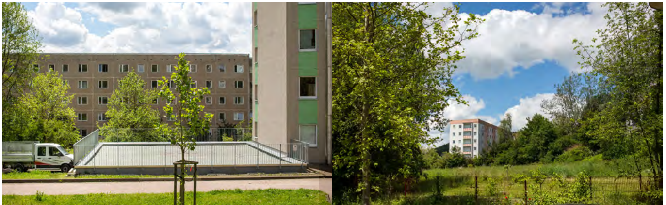
Abb. 43: Links: Erhaltenes Kellergeschoss des abgerissenen Gebäudes Allendestraße 26 bis 40, 2024. Rechts: Rückbaufläche im Gebiet, 2024. Fotos: GRAS*
