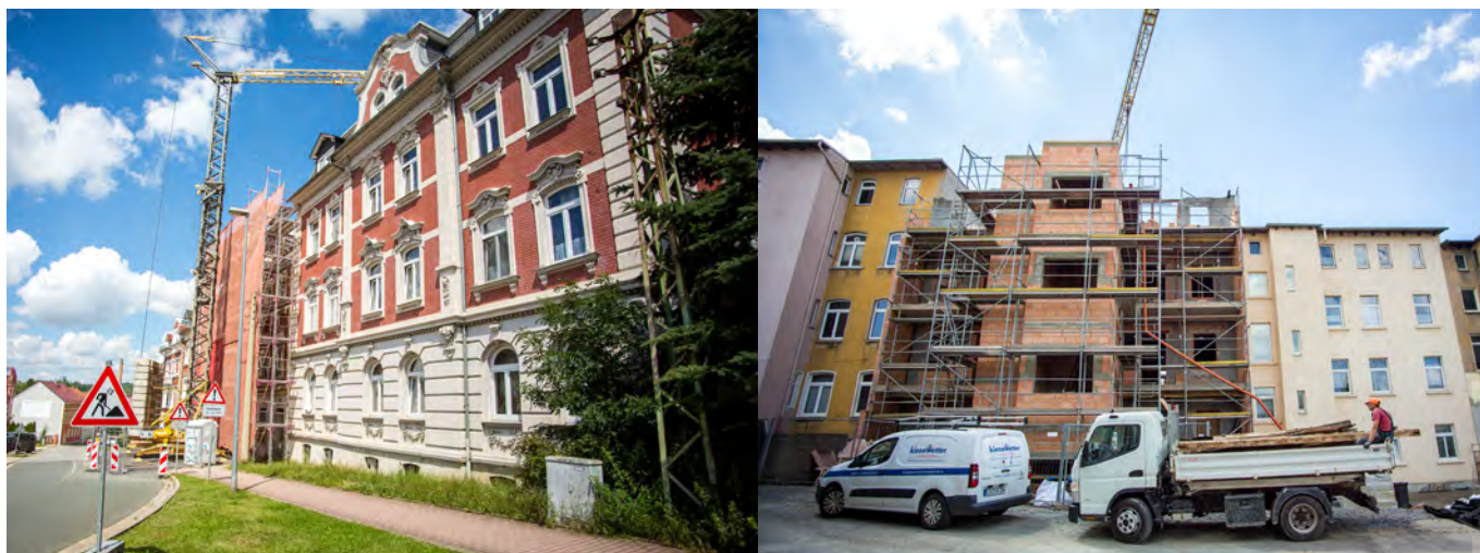
Abb. 21: Aktuelle Sanierungstätigkeit 2024 eines Privatinvestors am Kreisverkehr Schützenplatz. Die Klinkerfassade wird straßenseitig aufgearbeitet, rückwärtig werden große Aufzüge angebaut. Fotos: GRAS*
